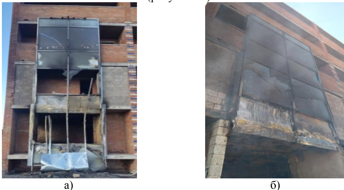
Рисунок 13 – Последствия воздействия пожара на светопрозрачный фасад здания: а) без защиты; б) с защитой
